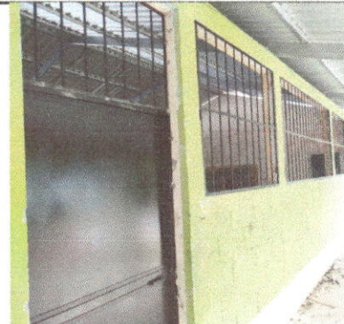
FOTO 4: Sustrucción de balcones a metal
